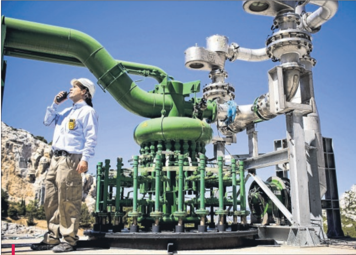
Parmi les nombreux équipements à l'actif du Seramm, la station d'épuration Géolide.
